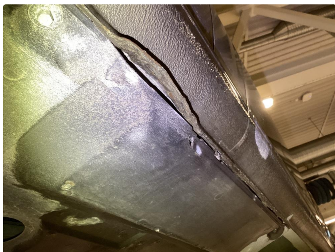
1.4 Skade på kanal venstre side , under.
